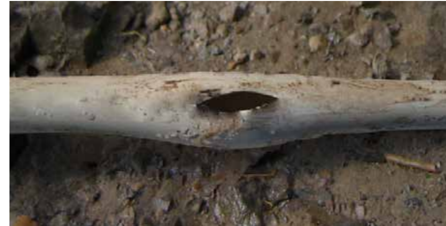
Undichte Abwasserleitung können zu erheblichen Schäden an Ihrer Bausubstanz führen. Nicht selten begegnen unseren Fachleuten Risse, wie bei diesem PVC-Rohr.
